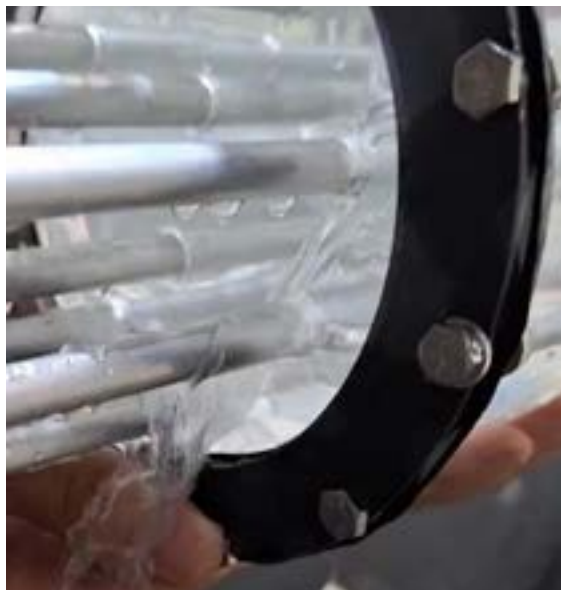
FIGURA 14 — Vazamento no trocador de calor
