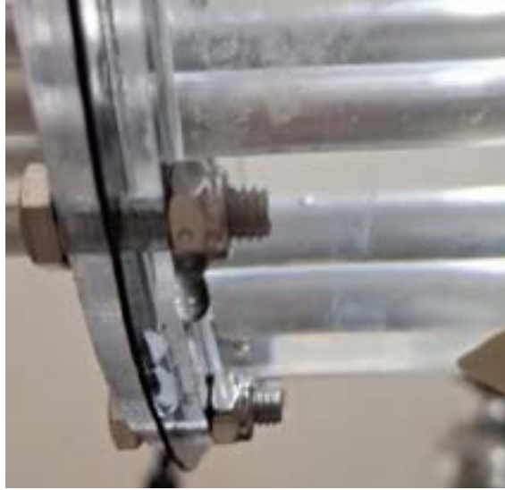
FIGURA 15 — Vazamento no trocador de calor
