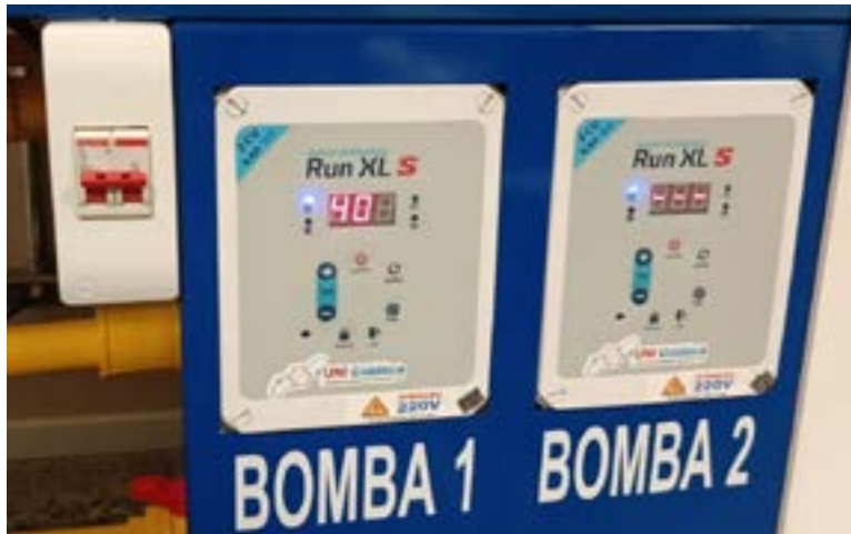
FIGURA 29 — Inversores de frequência da bancada hidráulica
