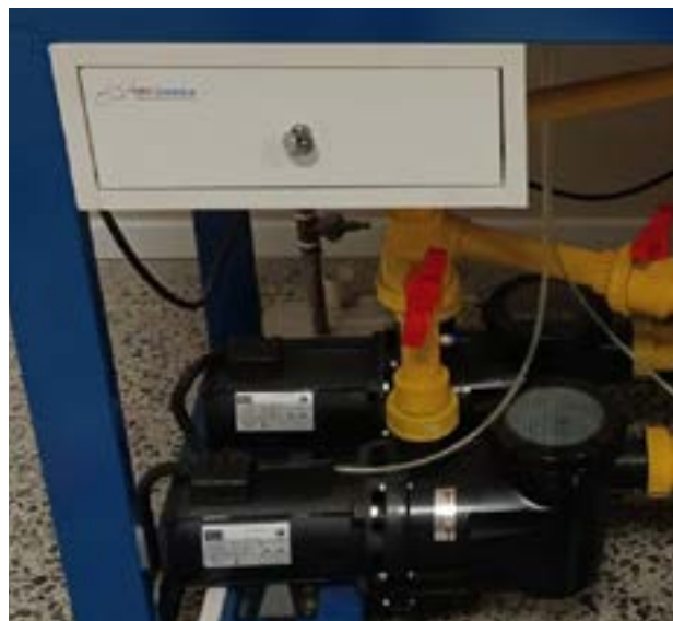
FIGURA 30 — Bombas da bancada hidráulica
